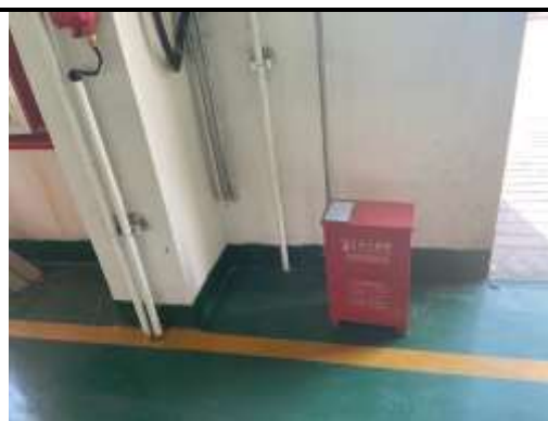
危险废物暂存间应急物资
