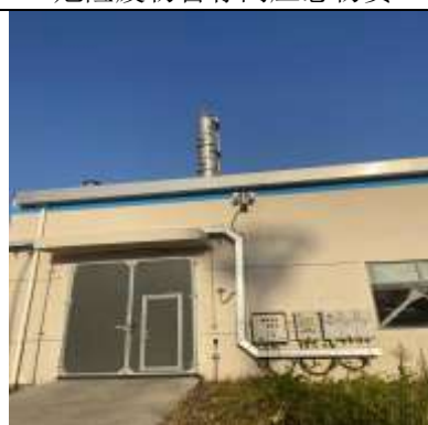
危险废物暂存间视频监控措施（外部）
