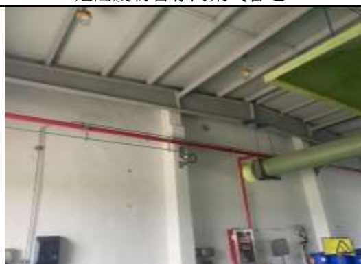
危险废物暂存间视频监控措施（内部）
