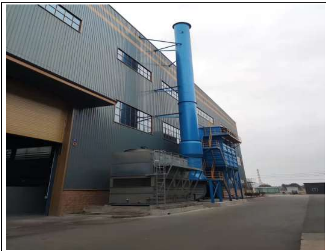
图 4.1-1 熔化炉烟气治理设施现场照片
