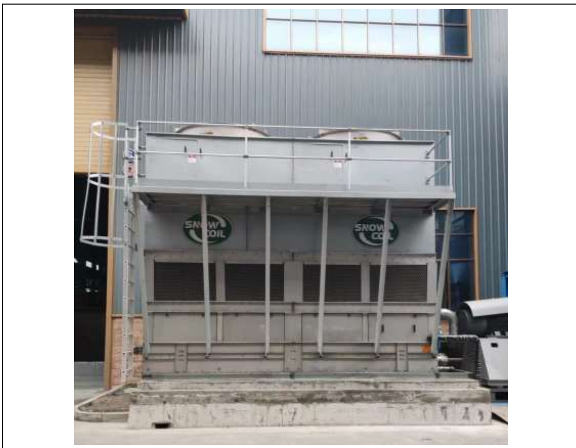
图 4.2-2 清环水系统现场照片
