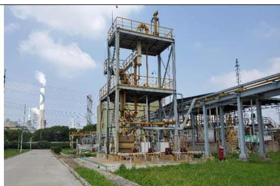
罐区水喷淋设施处理设施现场图
