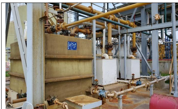
一级水喷淋处理设施现场图
