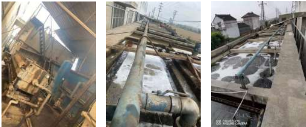
图 4-4 兴化市时潮不锈钢制品厂污水处理实际建设照片
