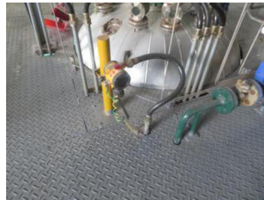
车间有毒气体检测仪照片
