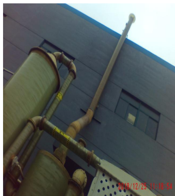
图 4.1-1 (4) 氨基脂肪族车间二级喷淋废气 处理装置
