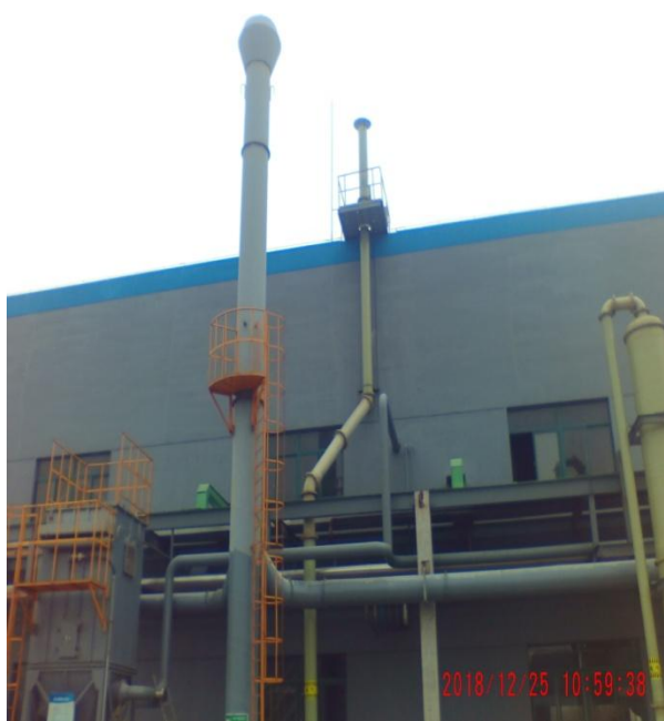
图 4.1-1 (3) 苯系车间冷却沉降+二级喷淋 废气处理装置
