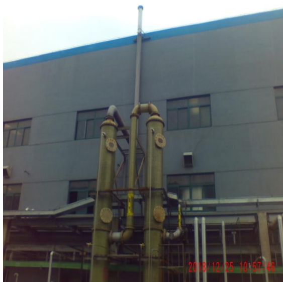
图 4.1-1 (1) 新型化学建材车间二级喷淋+活性炭吸附废气处理装置
