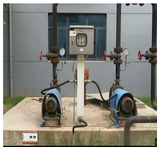
生活污水处理设施
